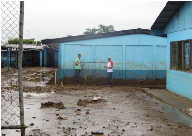
Figura 3. Nivel máximo alcanzado por la inundación en la escuela frente al parque de Upala
