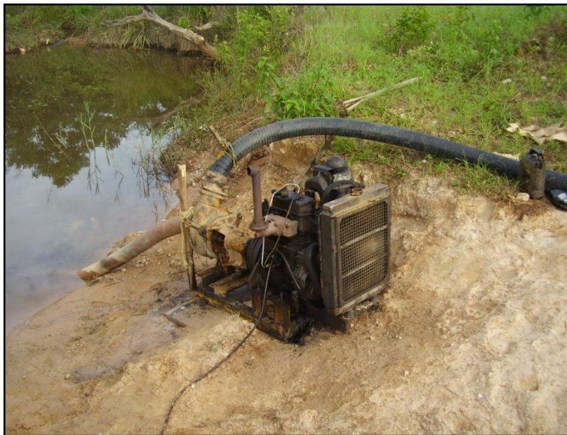
Figura 13. Bomba d'água, com pequeno vazamento de combustível. Fonte: LEMES, Denise Peralta (2009).
